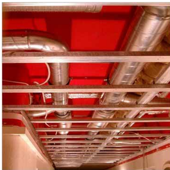
Lüftungs- und Heizleitungen unter Flurdecke (Foto: Dr. Schulze Darup)
