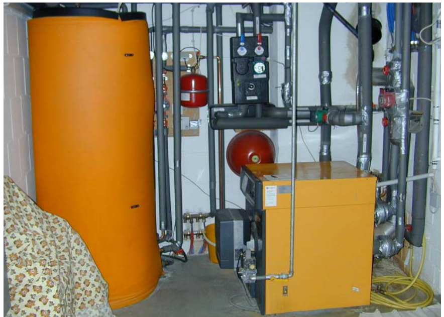
Geeigneter Aufstellungsort für den Speicher ist meist der Heizungskeller – der Anschluss des Heizkessels für die Nachheizung ist leicht möglich.
