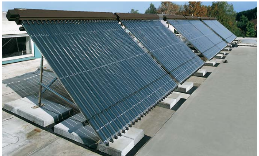
Feld aus Vakuumröhrenkollektoren, aufgeständert auf einem Flachdach
