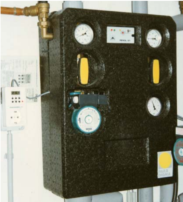
Solarstation: Pumpe, Thermometer, Manometer und Absperrventile sind zusammen in eine Dämmschale eingebaut.
