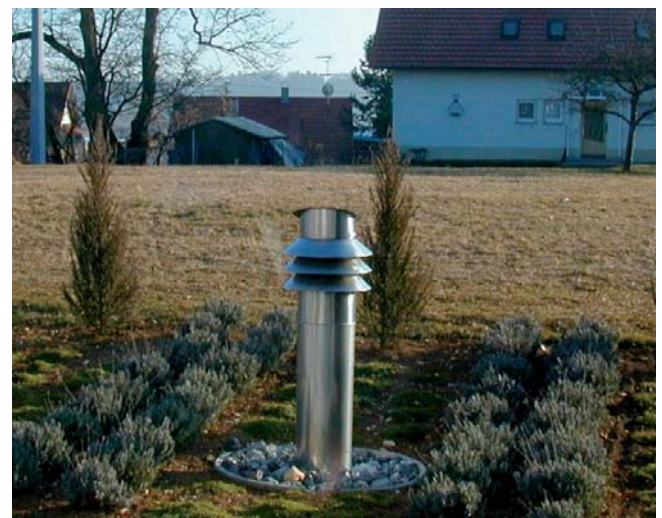
Frischluftansaugung am Ende eines Erdreichwärmetauschers
