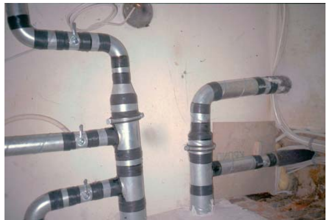
Von unten gegen die Decke fotografiert: Teile eines Kanalnetzes aus Wickelfalzrohr. Alle Verbindungen sind zum Schutz gegen Leckagen mit elastischem Klebeband verschlossen.
