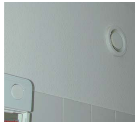
Abluftventil in einem Bad
