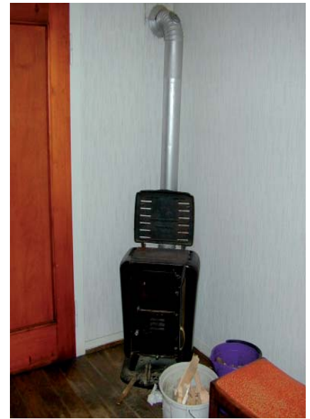
Er hat früher während der Heizperiode den Luftwechsel diktiert: Der Ofen im Wohnraum.
