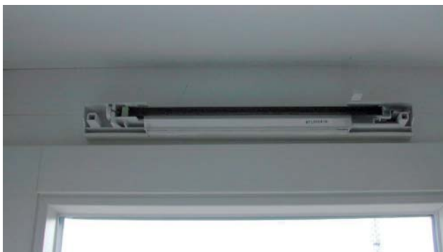
Feuchtegesteuerter Zulufteinlass über einem Fenster (Abdeckung entfernt)
