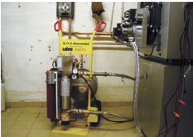
Das S.O.S. Heizmobil von Laing überbrückt im Heizungskeller die Zeit während des Kesseltausches.
