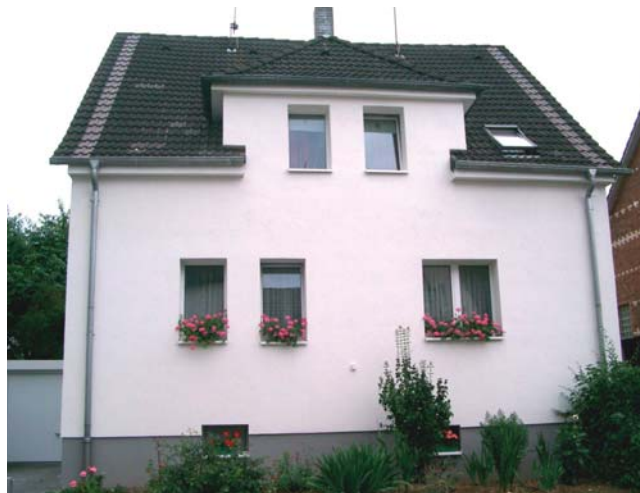
Bei diesem Haus wurde der Dachüberstand um eine Ziegelbreite vergrößert, um eine Außenwanddämmung möglich zu machen. Die Reihe der neuen Ziegel dient dabei auch als Gestaltungselement.
