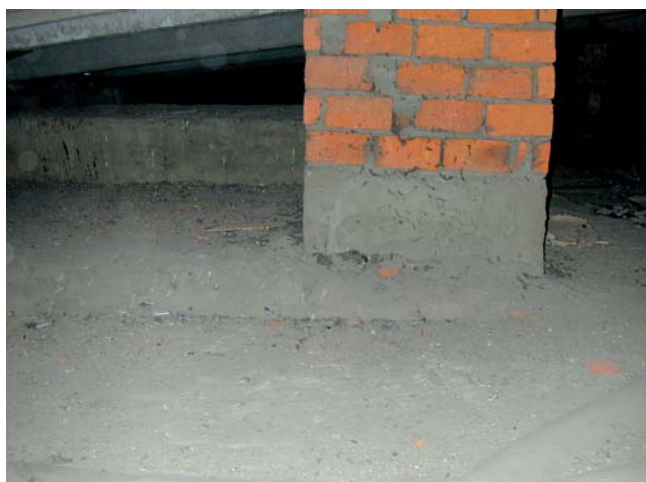
Dachboden: Zugänglich und nicht ausbaubar, also hätte er laut Energieeinsparverordnung bis zum 31.12.2006 auf einen U-Wert von 0,3 \text{ W}/(\text{m}^2\text{K}) verbessert werden müssen. 20 cm Dämmstoff sind hier leicht ausgerollt.
