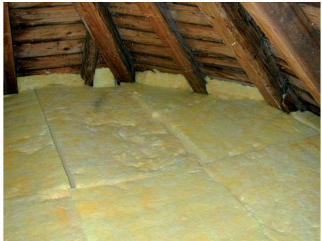
Mineralfaserplatten von 20 cm Stärke dämmen diesen Spitzboden. Die Platten sind auch in den Sparrenzwischenraum hineingeschoben. Damit schließt die Dämmung an die Zwischensparrendämmung lückenlos an.
