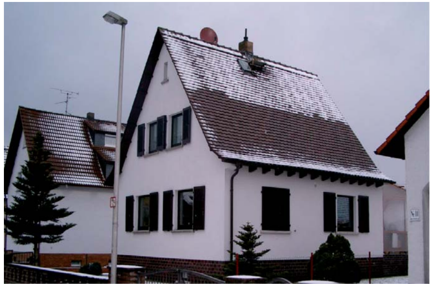
Die Wärme, die den Schnee auf diesem Dach geschmolzen hat, stammt aus der Heizanlage und hat den Hausbesitzer viel Geld gekostet.
