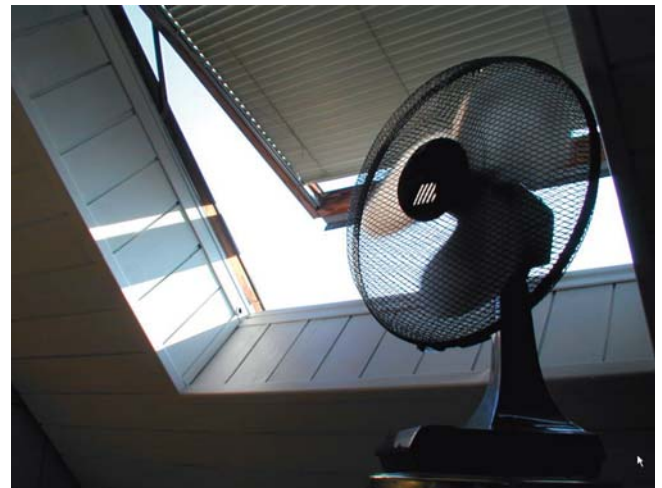
70-80°C heiß wird es im Sommer auf Dacheindeckungen - 20 cm Dämmstoff und innere Speichermassen sind ein guter Schutz dagegen. Der innen liegende Sonnenschutz des Dachflächenfensters ist dagegen wenig wirksam. Er muss außen liegen.
