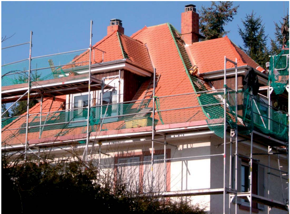
Die Erneuerung der Dacheindeckung ist ein guter Zeitpunkt für die Verbesserung der Wärmedämmung. Sonst ist die Chance wieder für 50 Jahre vertan.
