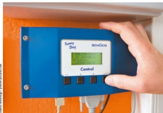
Kurze Einführung: Wechselrichterdisplays oder Datenlogger (Foto) zeigen Betriebszustände der Anlage an; der Installateur sollte sich aber unbedingt die Zeit nehmen, seinen Kunden dies auch zu erläutern
