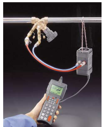
Abb. 5: Einregulierung mittels Meßcomputer „OV DMC 2“
